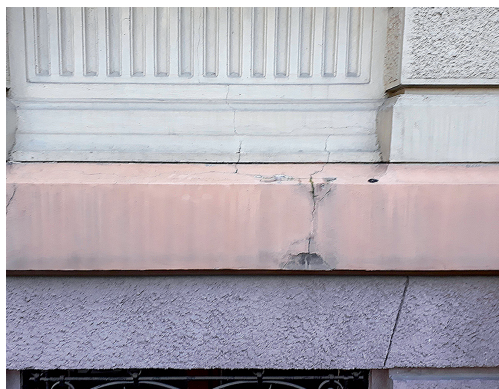
Fragment elewacji z widocznymi licznymi spękaniami warstw tynku
