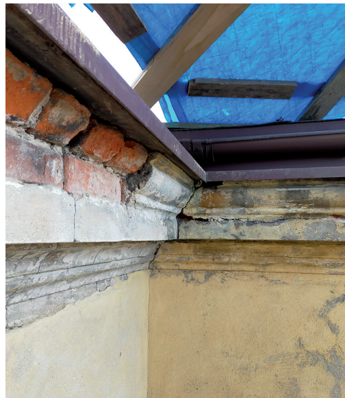
Gzyms przed pracami
