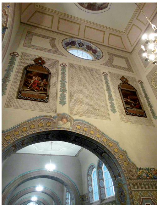
Polichromie z wysoleniami na ścianie transeptu przed i po pracach konserwatorskich
