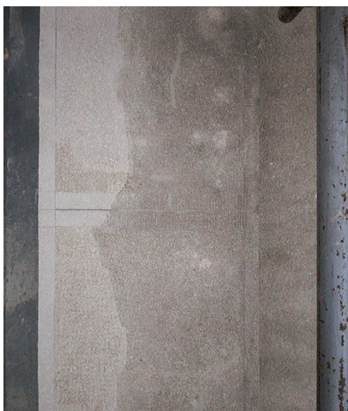
Elewacja frontowa kamienicy przy ul. Brackiej 11 w Krakowie, wykonana w tynku kamieniarskim, widoczne uzupełnienia tynku kamieniarskiego wykonane w technologii tradycyjnej. Fot. K. Feć-Sfora, Archiwum Art Forum Bożena Boba-Dyga
