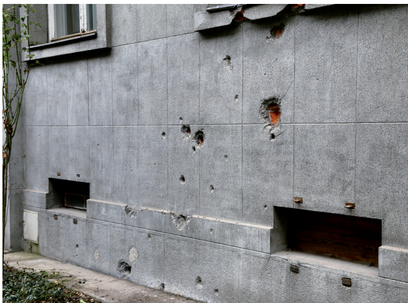
Dekorowany płukanym tynkiem cokół został uszkodzony podczas działań wojennych. Pozostawiono postrzeliny jako ślad historii budynku. Fot. A. Hardt
