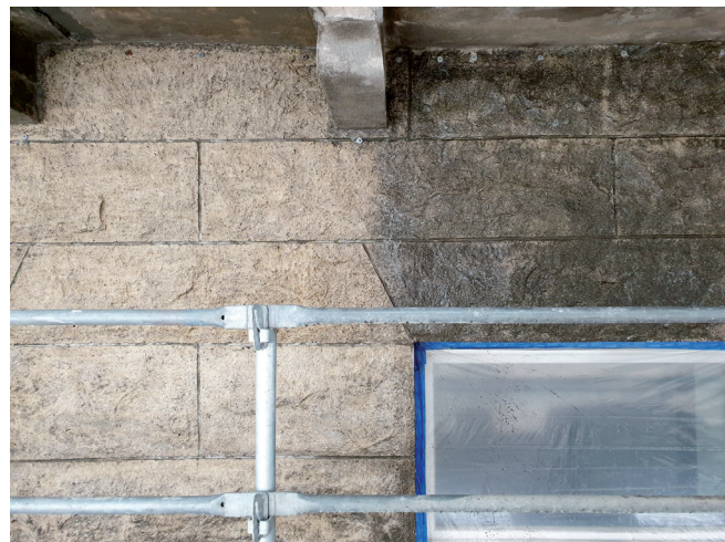
Elewacja frontowa kamienicy przy ul. Straszewskiego 24 w Krakowie, wykonana w tynku szlachetnym, stan w trakcie oczyszczania z zabrudzeń atmosferycznych i powłoki mleczka cementowego. Fot. K. Feć-Sfora, Archiwum Art Forum Bożena Boba-Dyga
