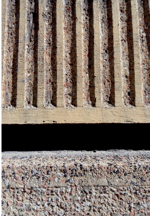
Podkreślenie walorów fakturowych tynku kamienniarzkiego osiągnięto przez zestawienie powierzchni pokrytej farbą i przeciętej dłutem – ryflowanie. Fot. M. Bogdanowska
