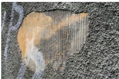
Tynk szlachetny o fakturze żłobkowanej w kolorze szarym i ugowym widoczny pod wtórnym tynkiem nakrapianym.
