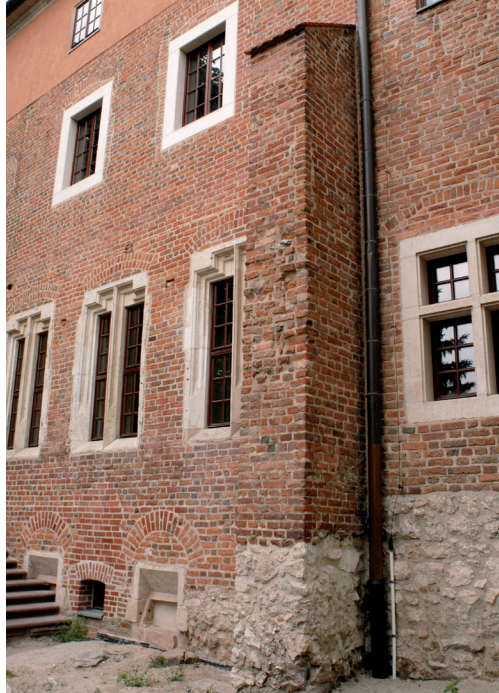
Zamek Królewski na Wawelu – budynek nr 7. Elewacja frontowa (płd.) – dom B. Stan przed konserwacją (fot. po lewej, luty 2006) i po konserwacji (fot. po prawej, sierpień 2009). Fot. B. Opilto
