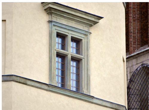
Zamek Królewski na Wawelu. Fragment elewacji północnej wieży Sobieskiego – widoczne odspojenia zewnętrznej warstwy tynku i stan kamieniarki. Stan przed konserwacją (fot. po lewej, czerwiec 2011) i po konserwacji (fot. po prawej, październik 2011). Fot. J. Śliwa
