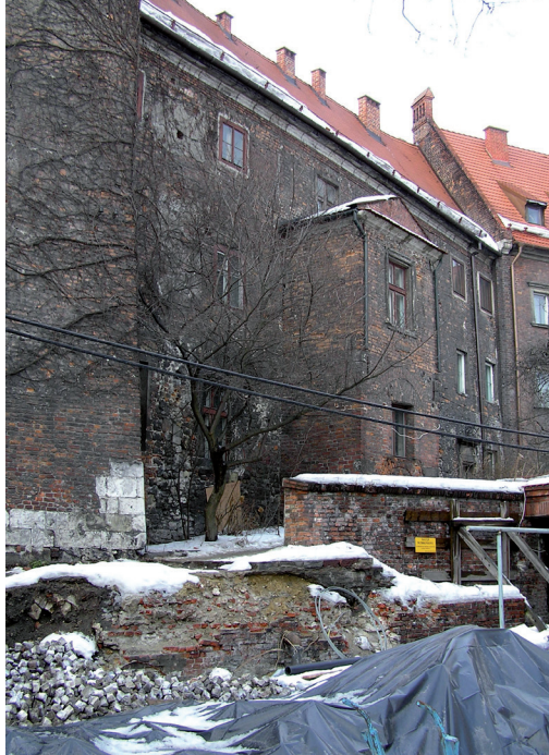
Zamek Królewski na Wawelu – budynek nr 7. Elewacja frontowa (płd.) – dom A. Stan przed konserwacją (po lewej, luty 2006, fot. B. Opiłło) i po konserwacji (po prawej, sierpień 2009, fot. P. Piotrowski)
