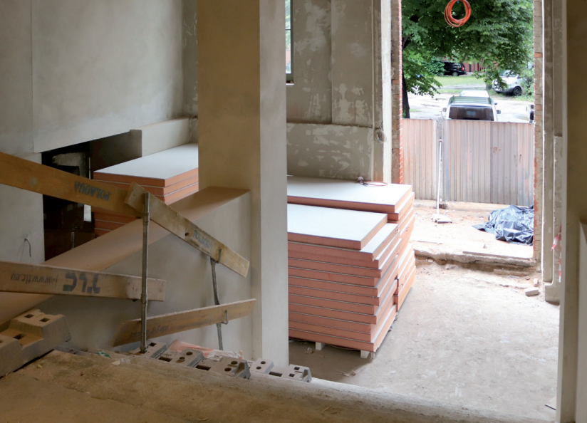
Termomodernizacja budynku z użyciem płyt z pianki rezolowej Kooltherm® K17 do izolacji wewnętrznej
