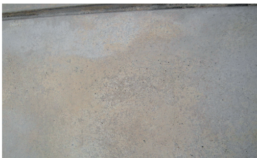
Fragment tynku po wykonaniu prac konserwatorskich, które polegały na bardzo precyzyjnym uzupełnieniu ubytków
