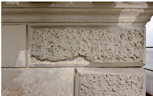
Wykończenie tynkowanych powierzchni pałacu przed remontem
