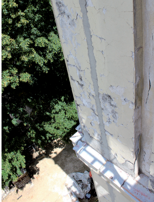
Elewacja zewnętrzna północna, widoczne zniszczenia tynków i degradacje powłok malarskich
