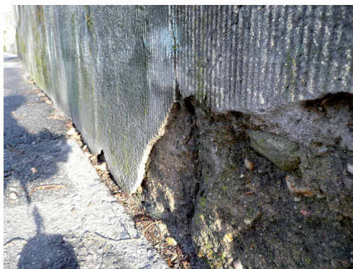
Uszkodzenia tynku czesanego oraz znaczne ubytki w podłożu betonowym.
