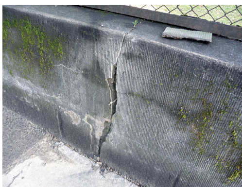
Spękania betonowej belki podwalinowej.
