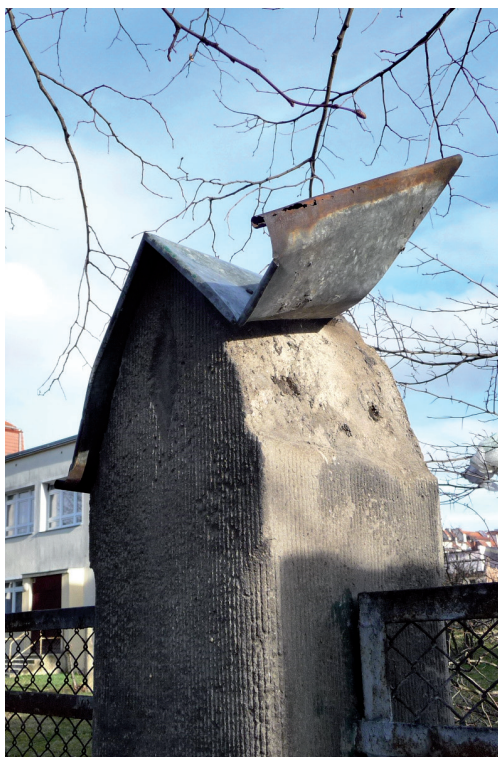
Uszkodzenia obróbek blacharskich i betonowych słupków.
