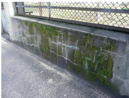
Mchy porastające powierzchnię muru.
