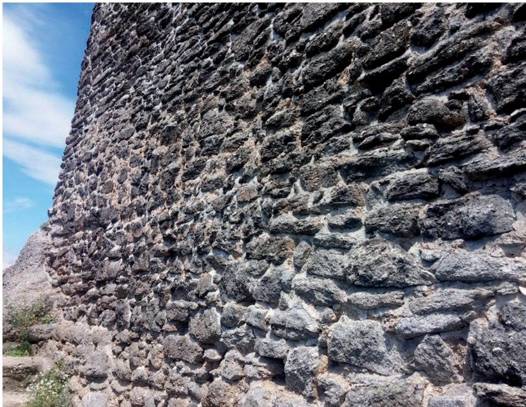
Mury zamku Chojnik przed remontem.
