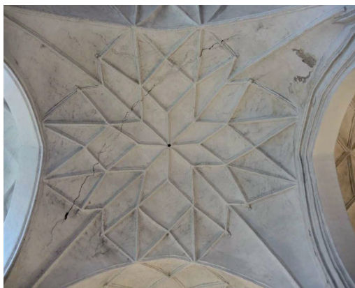
Rys. 5. Sklepienie przed zabiegami konserwatorskimi
