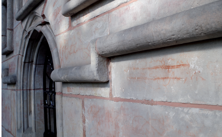
Fot. 2. Napisy pozostawione na elewacji przez pielgrzymujących
