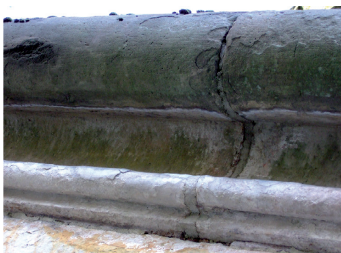
Fot. 3. Zniszczenia kamienia nakryw przed konserwacją
